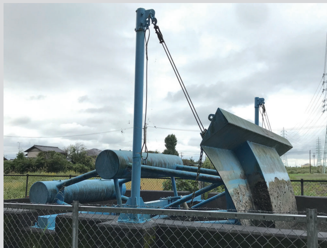
▲ 藻の付着・堆積により、鋼材表面と藻のすきま内で乾湿を繰り返し、大きく腐食。施工前。
