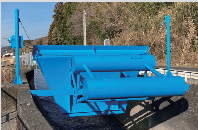
▲ 自動水位調整機。施工後。
